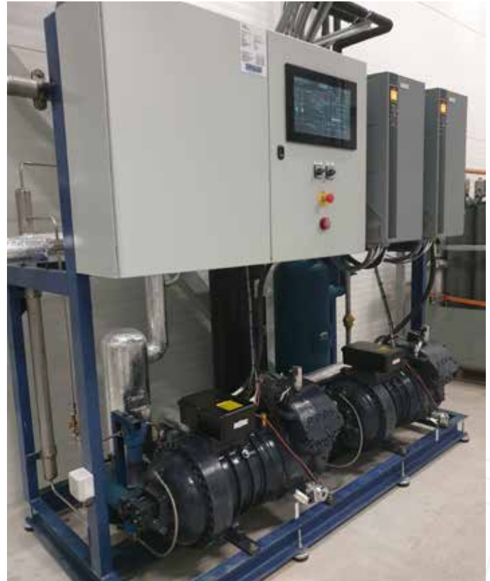
Kompressorskid med CO 2
