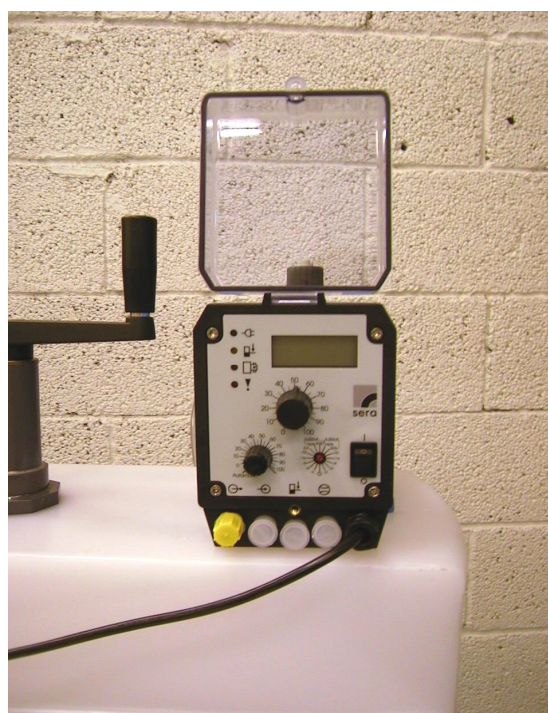
Pumpen har en rekke styringsmuligheter.
