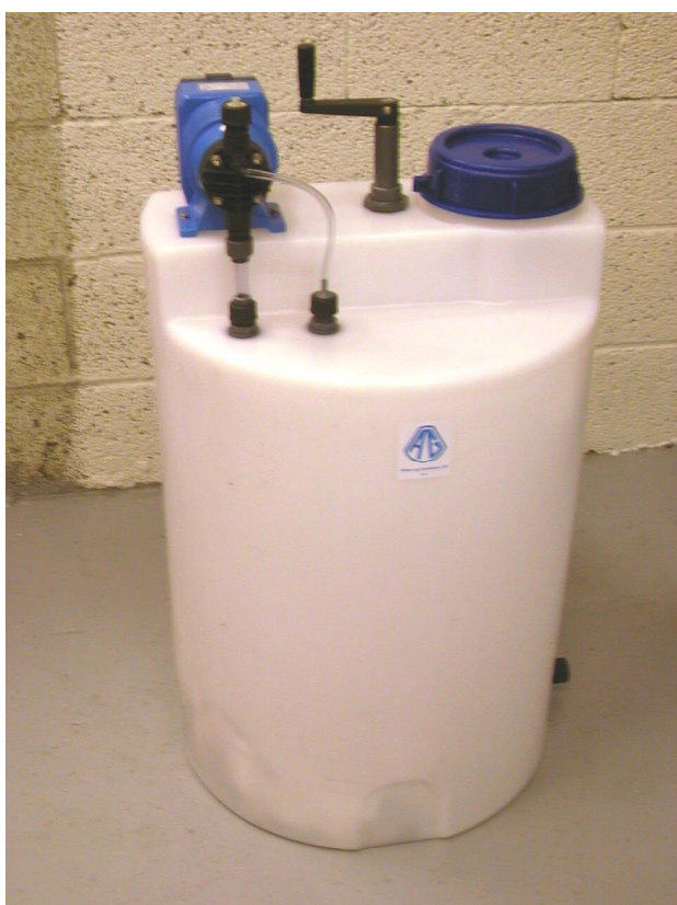
Kloreringsanlegg med 200 liter tank.
