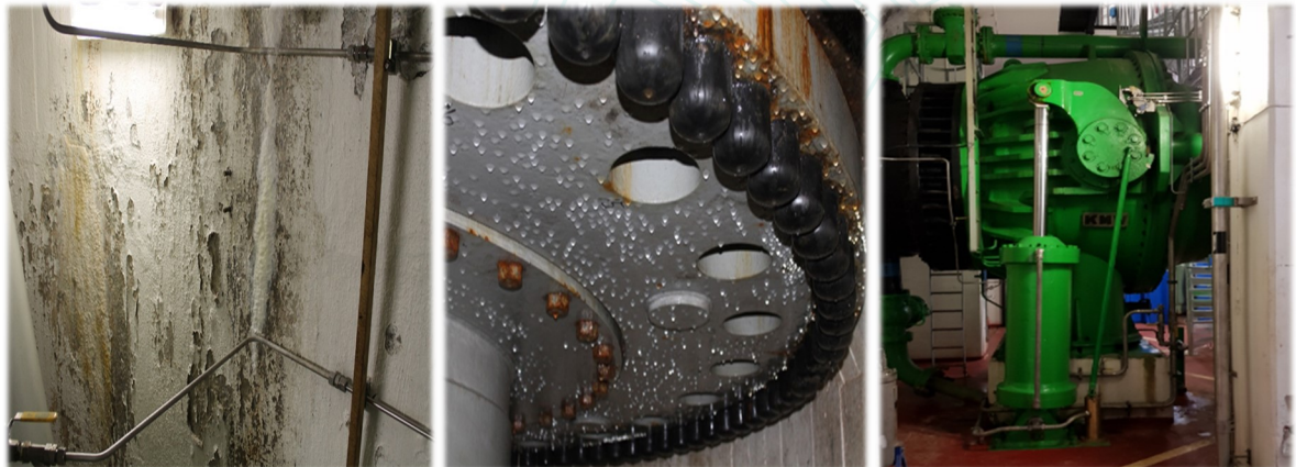
Kondens og korrosjon fører til store drift- og vedlikeholdskostnader i turbinkjellerne og sugerørskon.
